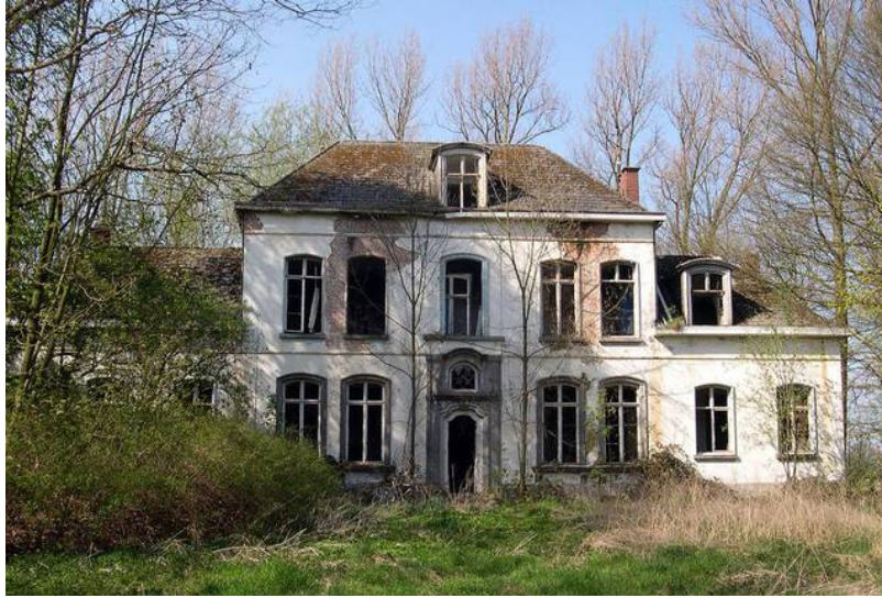
Pastorie Het Hof verkeert in een erg slechte toestand. - Foto WTW
